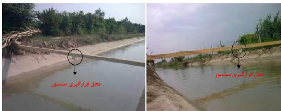
شکل ۳- نحوه قرارگیری عمق‌سنج التراسونیک نصب شده بر روی کانال در شبکه آبیاری تجن.
